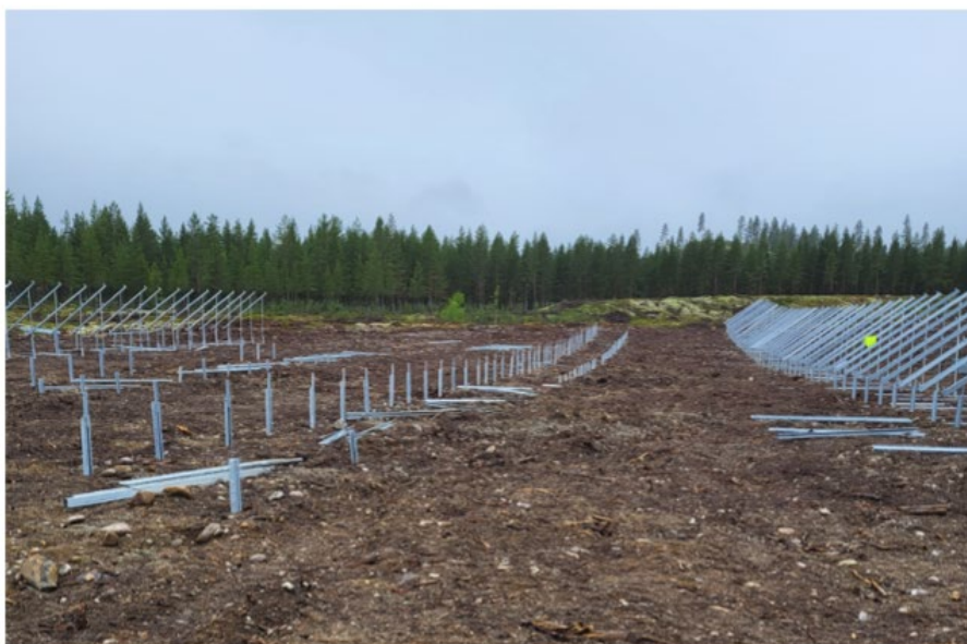
Bilde 3. Solcellestativer under montering i det nordre delområdet. Det forbores før peling, men stein raser tilbake i borehullet og gjør pelingen svært vanskelig. Stativene blir bøyd og skadet.
