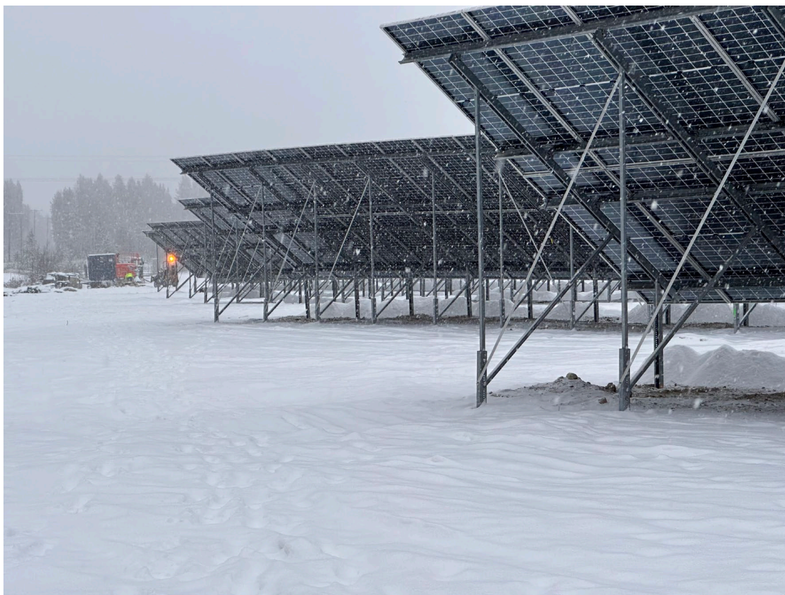
Bilde 1 Tosidige paneler i glass, 580W-605W, Furuseth Solpark Foto: Solcellespesialisten
