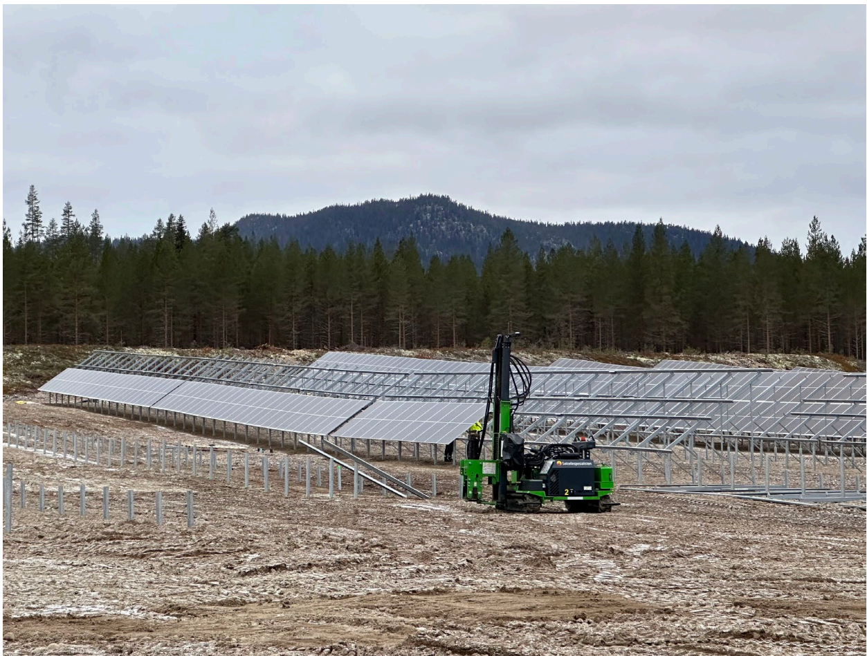
Bilde 3 Tosidige paneler i glass, 580W-605W, Furuseth Solpark Foto: Solcellespesialisten
