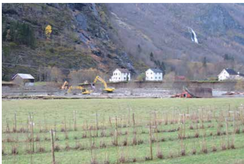
Flåm: Oppryddingsarbeid etter flommen høsten 2014
